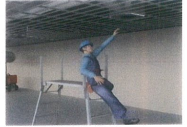
転落災害発生！！
